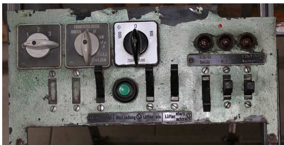
Abbildung 14: Schaltergruppe vor Instandsetzung
